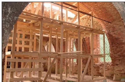
Деревянные леса под провалом свода храма.
